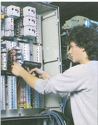
Und der Schaltschrank, das Gehirn des Profimat.
